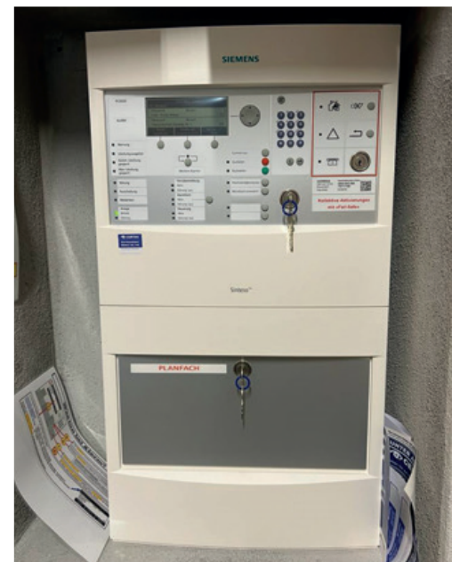
Brandmeldeanlage im EG Turm
